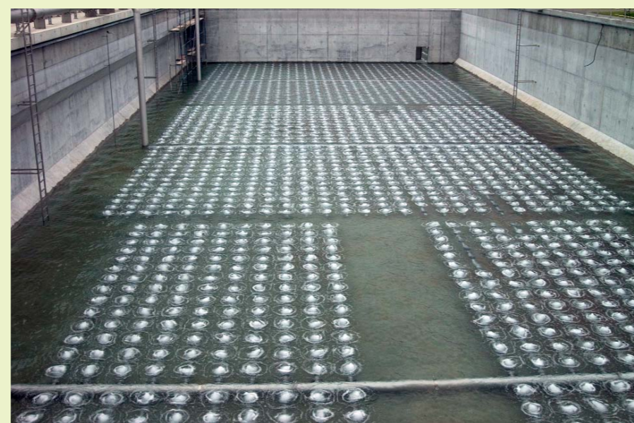
Der Belebtschlamm benötigt für die Reinigung des Abwassers viel Sauerstoff.
