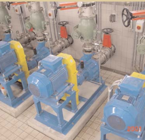
Abwasserpumpwerk der Stadt Fellbach
