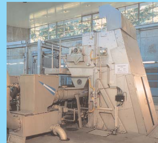
eingehauster Feinrechen in der Rechenhalle
