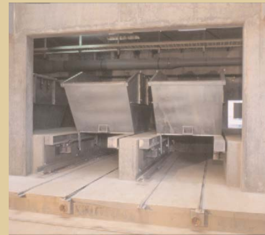
Container für Abfallstoffe in der Containerhalle
