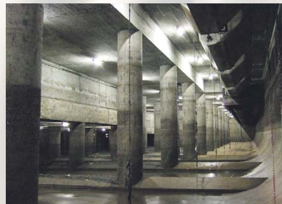
Das gigantische Regenüberlaufbecken am Schwanenplatz schützt den Neckar.
