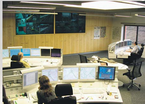
Beobachten, lenken, Staus vermeiden: Die Verkehrsleitzentrale in Bad Cannstatt ist bestens ausgerüstet.
