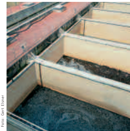
Filterkammern der Sandfilteranlage
