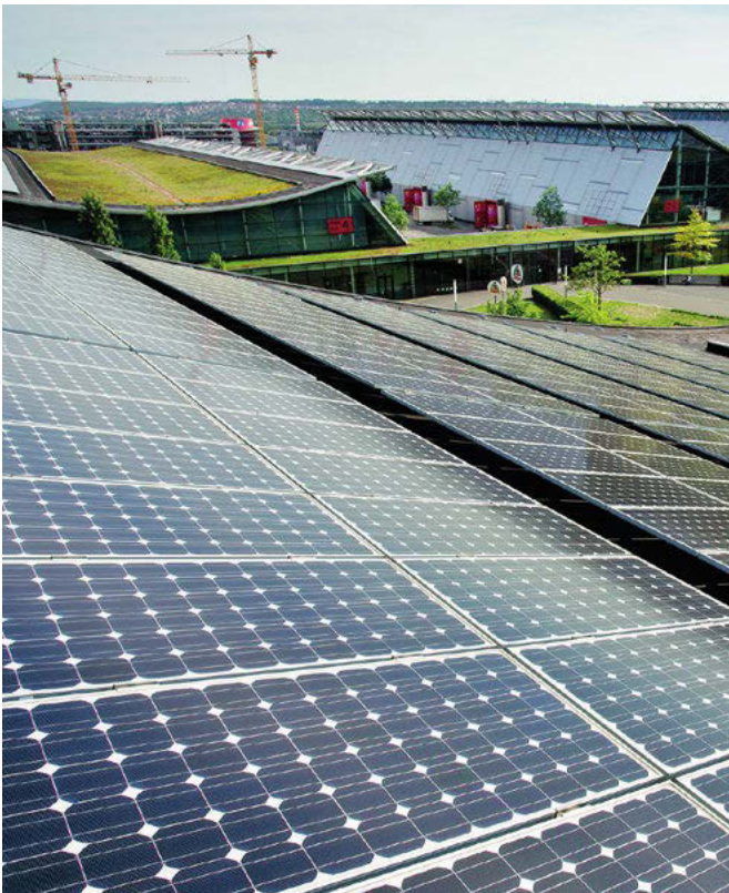
Fotovoltaikanlagen auf den Hallendächern der Messe Stuttgart
