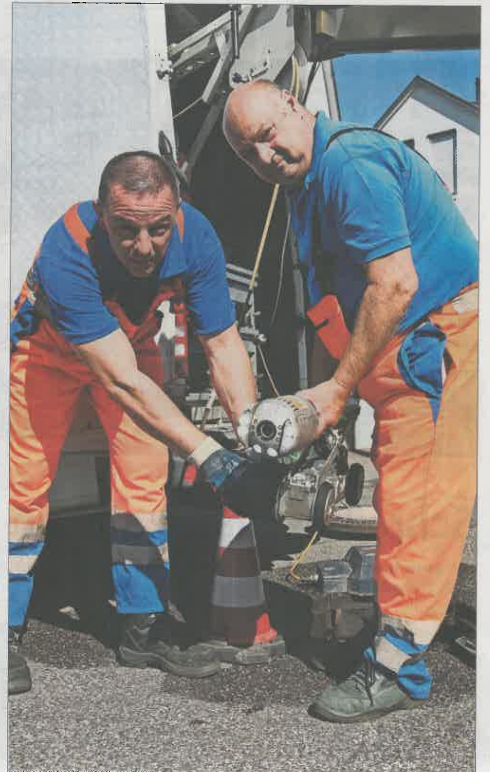
Die ferngesteuerte Kamera, die auf einem Elektrowagen durch die Kanäle fährt, ist das wichtigste Arbeitsgerät von Gerhard Lechner (rechts) und Pretrag Zupetic. Foto: Bernd Zeyer
