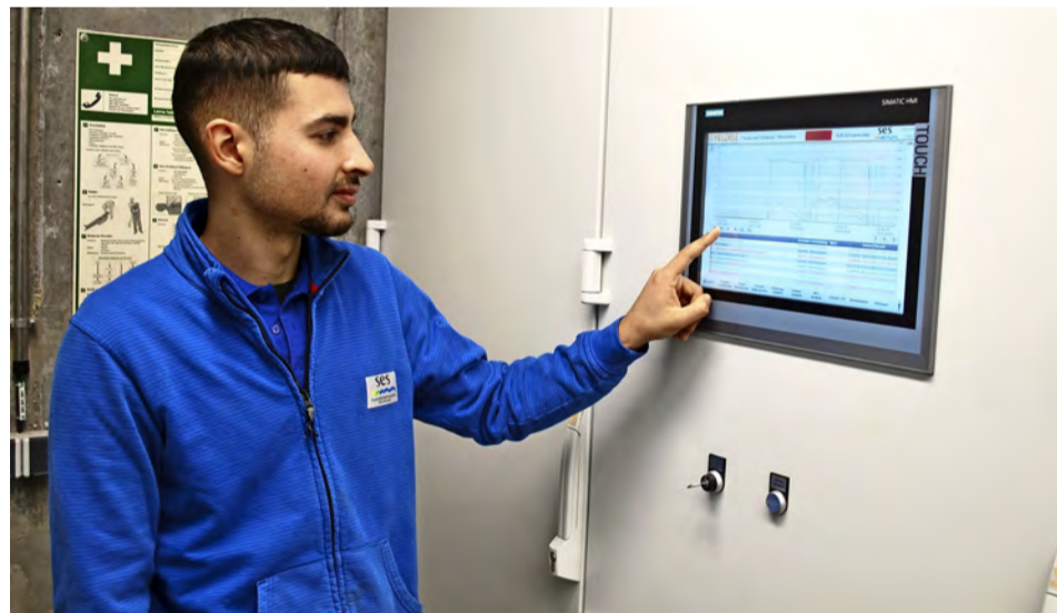
Yunus Yazici von der Stadtentwässerung Stuttgart kann am Touchscreen unter anderem die Funktionen der Pumpen kontrollieren.
